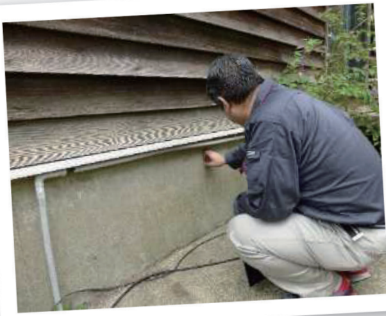
基礎（ひび割れ等）
