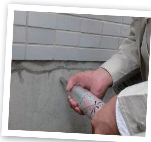
コンクリート強度
